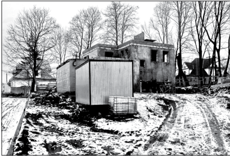
Ход будаўніча-мантажных работ на восьмым месяцы. Аднак будоўля пакуль не мае пашпарта аб'екта і дазволу райвыканкама. Аўтарская хроніка, снежань, 2016 год
