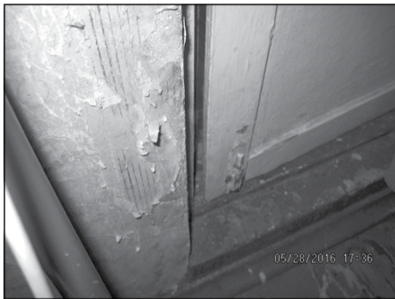
Балконныя дзверы, якія ЖЭС адмаўляецца мяняць
